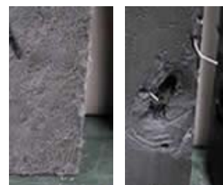
写真1 表面劣化状況 左: M-VF, 右: B-SF
