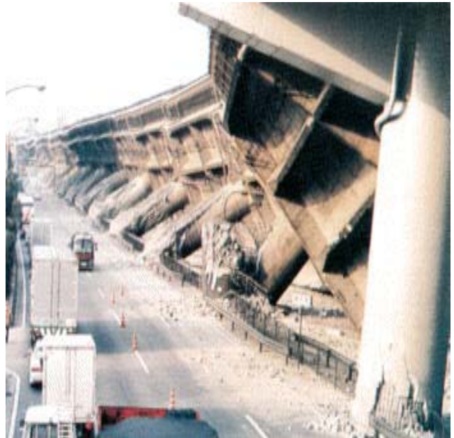
写真1 阪神高速道路3号神戸線の被害 (出典:1995年阪神淡路大震災スライド集 日本建築学会, 土木学会編)
