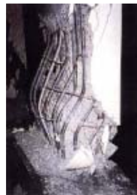
写真1 中柱の破壊状況 1)
