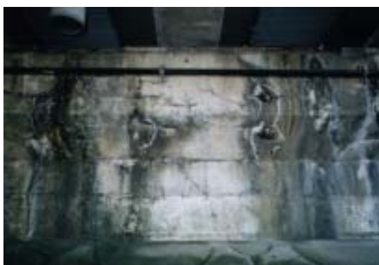
写真5 アルカリ骨材反応損傷例
