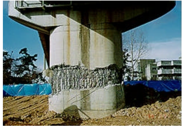
写真 1 鉄筋コンクリート橋脚の地震時の被害例
