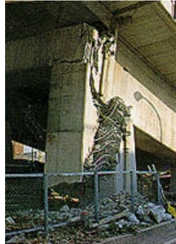
写真 1 鉄筋コンクリート橋脚の地震時の被害例
