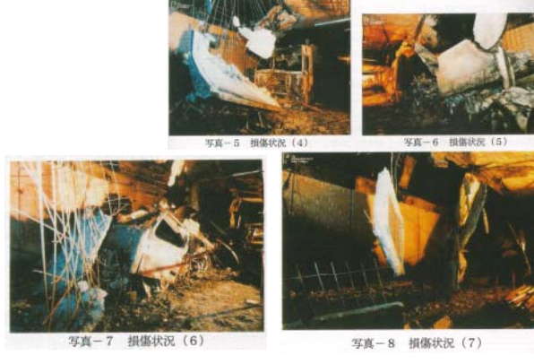
写真-5 損傷状況 (4) 写真-6 損傷状況 (5) 写真-7 損傷状況 (6) 写真-8 損傷状況 (7)
