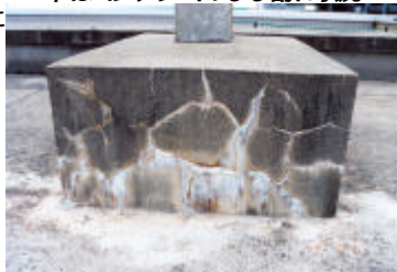
下はコンクリートのひび割れ状況
