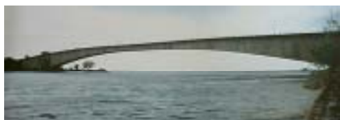
コロール・パベルタウブ橋 、パラオ共和国 ・1977竣工 ・中央ヒンジ付きプレストレストコンクリート箱げた橋 ・両岸からのカンチレバー張り出し工法 ・橋長385.2m、幅員9.6m
