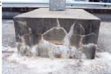
下はコンクリートのひび割れ状況
