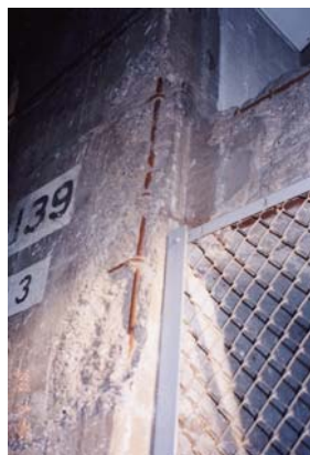
中性化による鉄筋腐食
