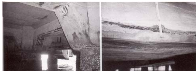
左: 鉄筋の腐食により、かぶりコンクリートが剥落している。
