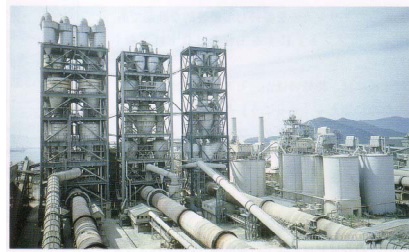
写真64 NSP方式の焼成装置 (手前の太い円筒が回転窯)
