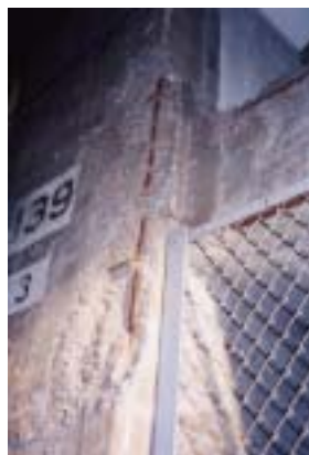
中性化による鉄筋腐食
