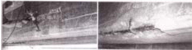
左: 比較的軽微なひび割れに見える箇所をはずっているところ。概観からは内部の損傷状況を判断するのは難しい。
