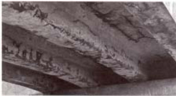
塩害で劣化した橋桁 かぶりコンクリートが剥落し、鉄筋が露出している。
