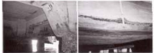
左: 鉄筋の腐食により、かぶりコンクリートが剥落している。
