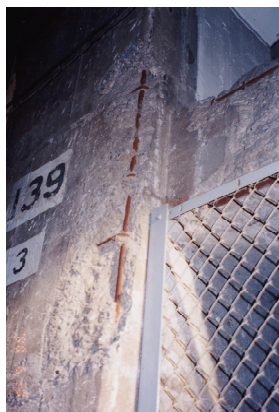
中性化による鉄筋腐食
