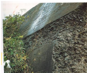
上: 凍害を受けた橋台 右: 工場製品の道路縁石に生じた凍害の事例
