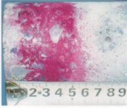
上: 橋脚のコア抜きをしている様子 左: コンクリートの中性化の状況調べるために、採取したコアをフェーラルフクレイン測定した後の状況。色が変わっていない範囲(左側)から10cm程度の深さまで中性化が進行している
