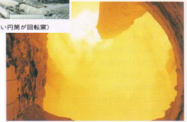
写真62 回転窯の内部
