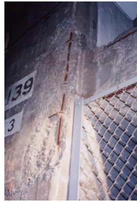
中性化による鉄筋腐食
